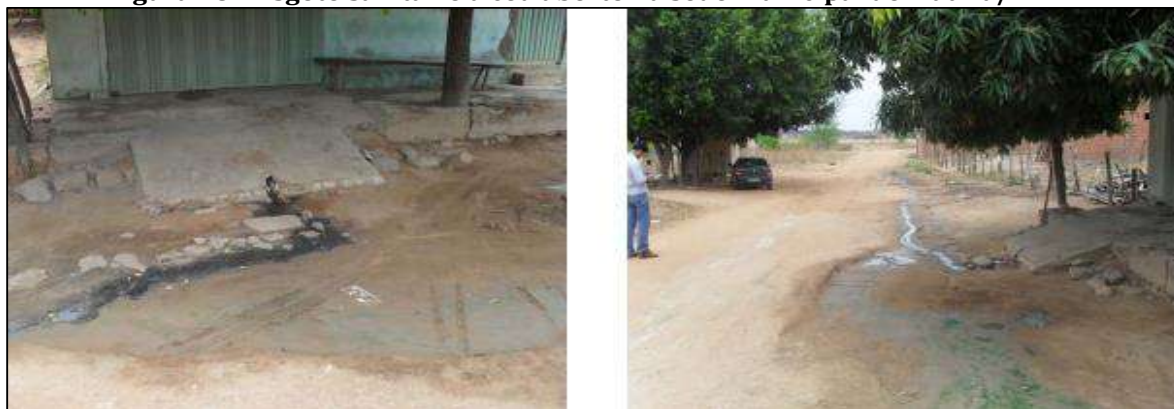
Figura 48 – Esgoto sanitário à céu aberto na sede municipal de Matina/BA
