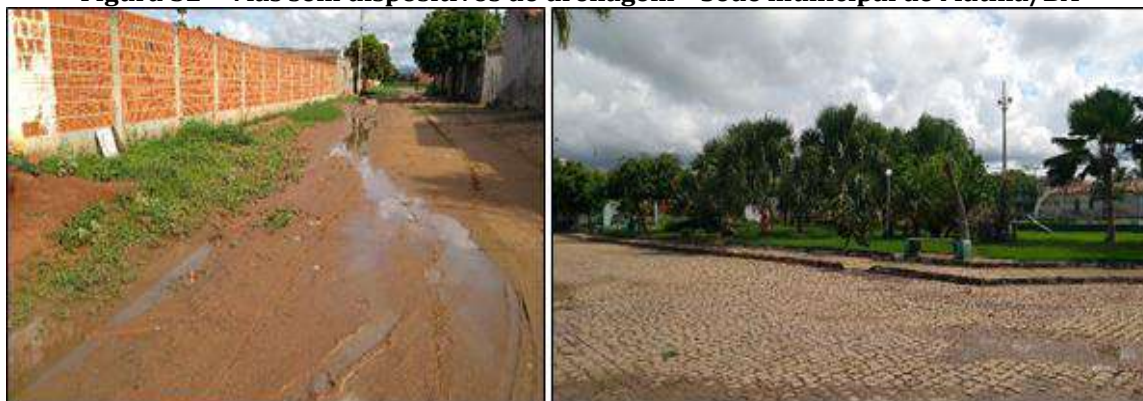
Figura 52 – Vias sem dispositivos de drenagem – Sede municipal de Matina/BA
