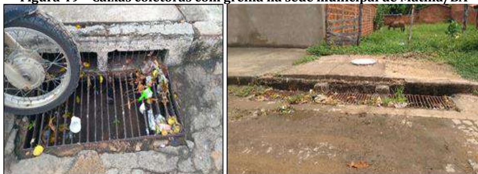
Figura 49 – Caixas coletoras com grelha na sede municipal de Matina/BA
